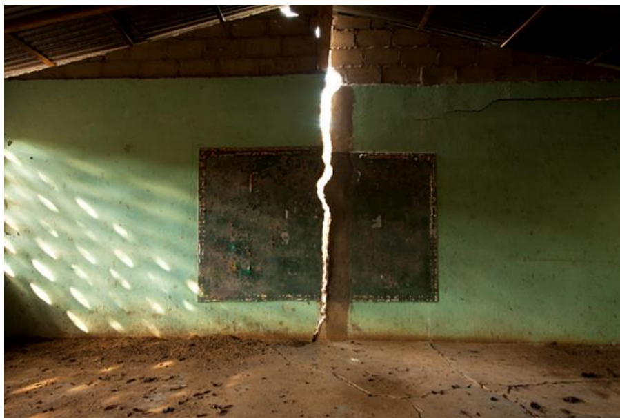
Fig. 5: Silencio con grieta
