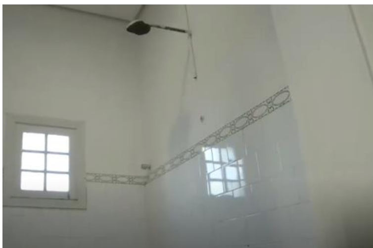
Figura 5 - detalhe do chuveiro quase no teto do banheiro- Foto: Sinara Medeiros
