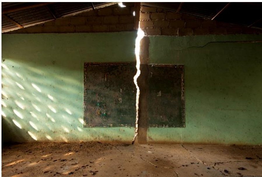
Fig. 5: Silencio con grieta
